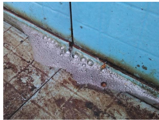
Filtración de agua de fuera a dentro
